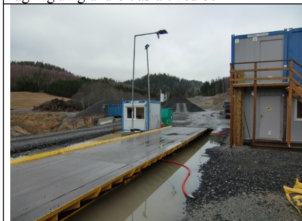
overfylt sandfangskum ved vekt
