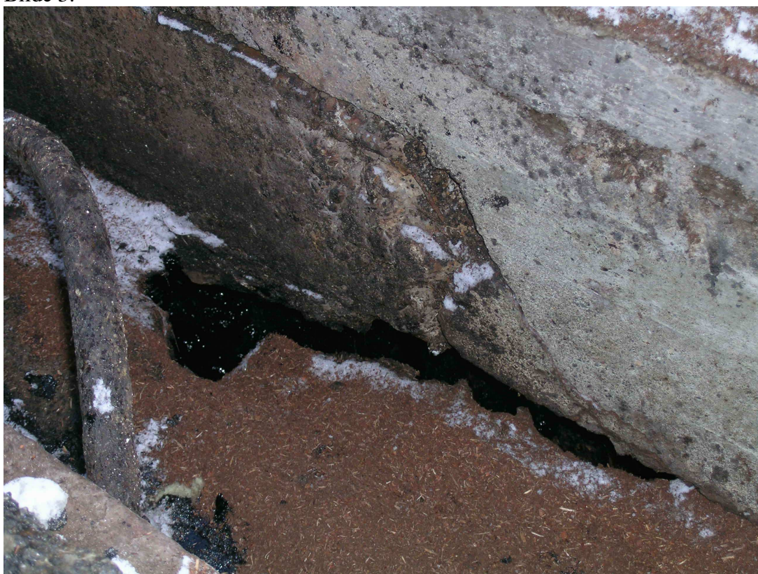
Hullet i kulverten der oljen drenerte ned i Glomma
