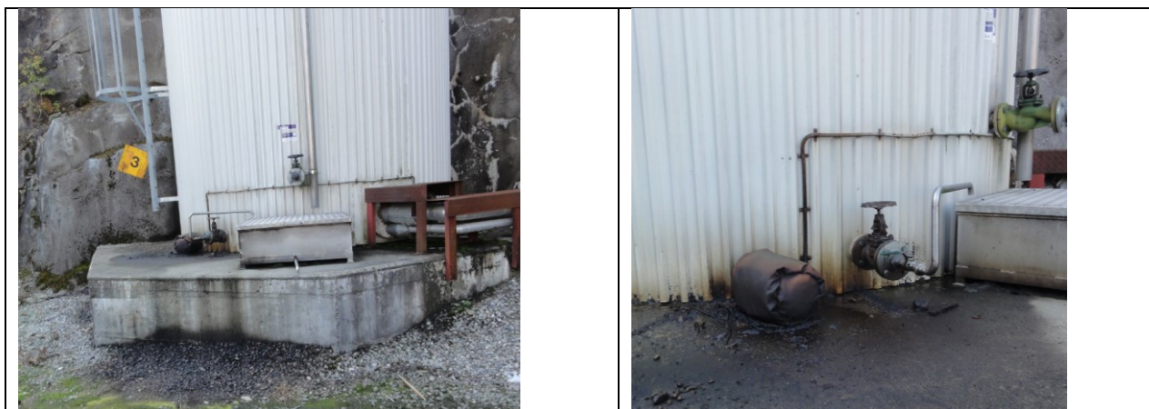
Tank med fyringsolje. Foto: Fylkesmannen i Oslo og Akershus
