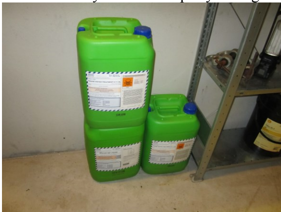
Bilde 1: Kjemikalier lagra utan oppsamlingsarrangement i rom med sluk og avløp til oljeutskiljar
