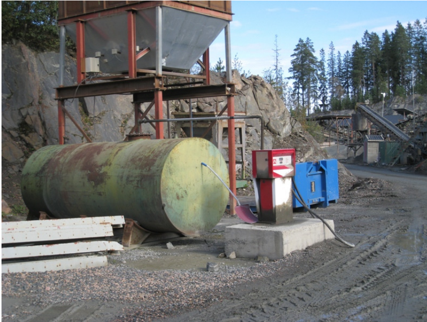
Dieseltank på 6 m 3 . Denne lagringen var ikke risikovurdert. Foto: Knut Roland / FMOP
