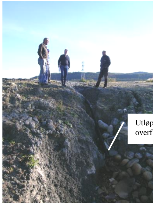
Bilde 6 Utløp drenering overflatevann foran kum
