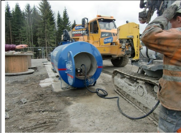
1 Dieselsøl i terrenget
