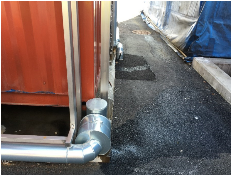
Bilde 1: Lekkasje av lut
