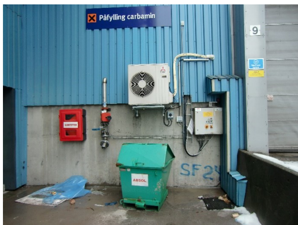
Figur 1 Sluk ved påfylling av Carbamin
