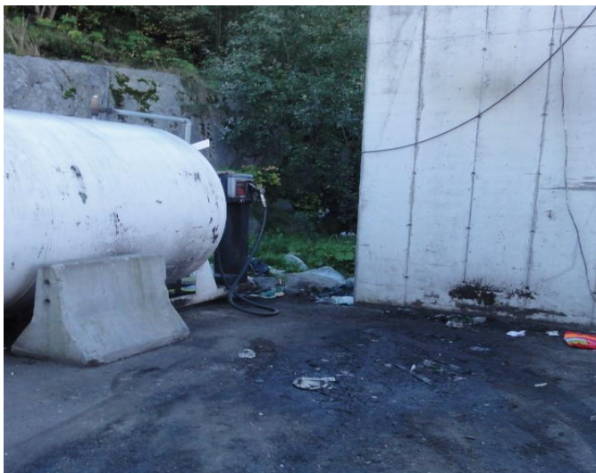
Dieseltank med pumpe og mye søl på bakken. Foto: Fylkesmannen i Oslo og Akershus.
