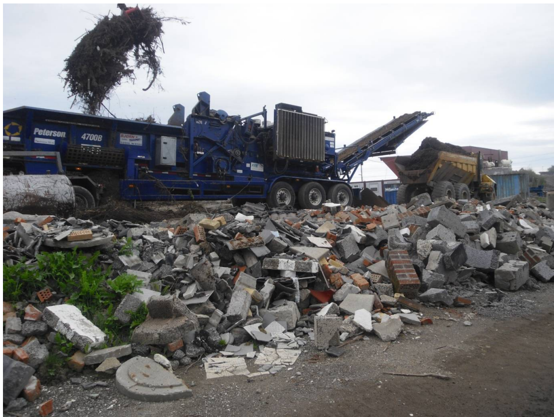
Bilde 1: Mellomlager av betong/tegl.
