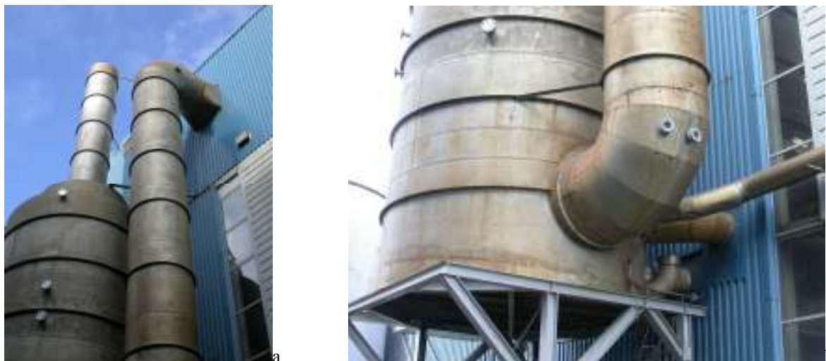
Bilde 4: Utvendig sjøvannsvasketårn med fyllegemer for utvasking av luktcomponenter fra romlufta.
