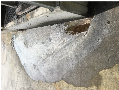
Lekkasje av olje ved tømme-stasjon for IBC-er
