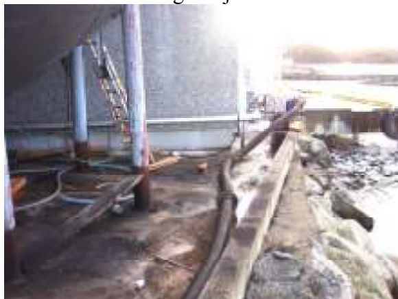
Bilde 2: Brudd nr. 1 i sikringskant.
