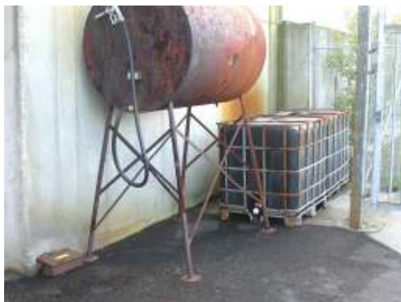
Bilde 1: Rusten dieseltank og 2 umerkede 1000 liters containere med etsende innhold.
