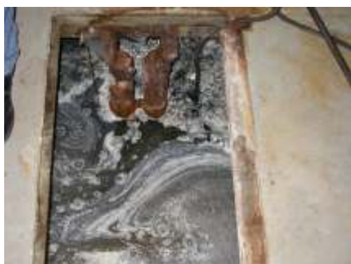
Bilde 3: Avløpskumme med rustangrep.
