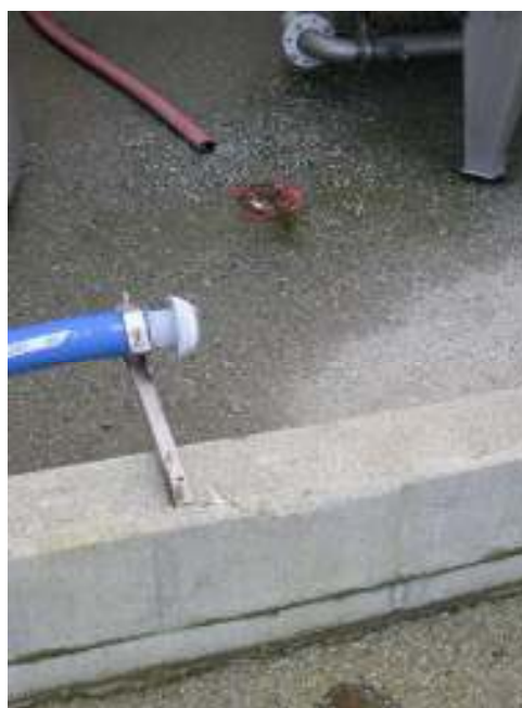
Bilde 6: Sluk i oppsamlingsbasseng.
