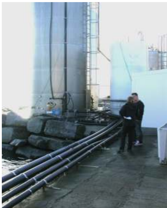
Bilde 5: Tankområde uten sikringsbasseng.
