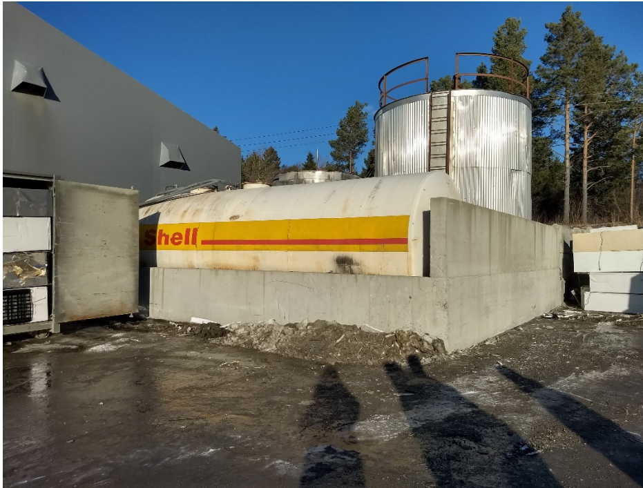
Bilde 1 Tanker (Foto: Fylkesmannen i Trøndelag 16.02.2018)
