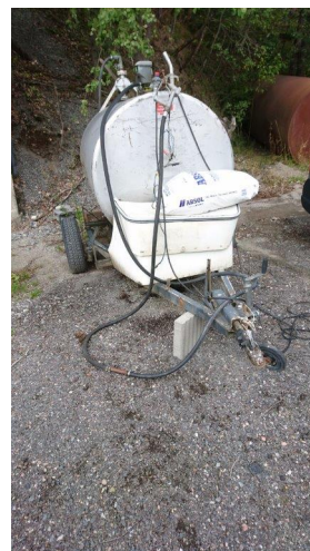
En 2 m 3 dieseltank står ved det tidligere betongverket. Det var noe søl i grunnen under befaringen (ikke tett dekke – men absol tilgjengelig).
