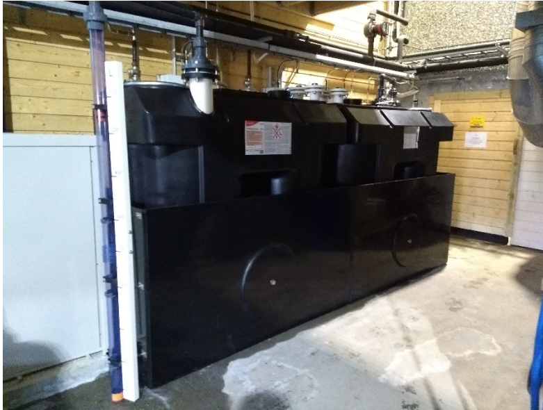
Bilde 1 Lagringstank (Foto: Fylkesmannen i Trøndelag 06.04.2018).
