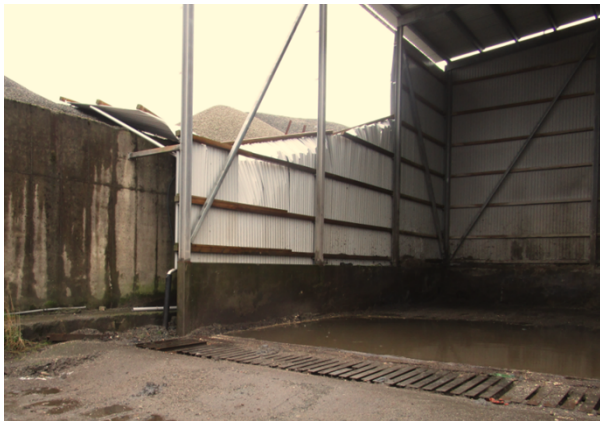
Bilde 2: Store deler av langvegg ligger igjen nede, og vann regner inn i hallen. (Bildet er tatt 29.11.2018)
