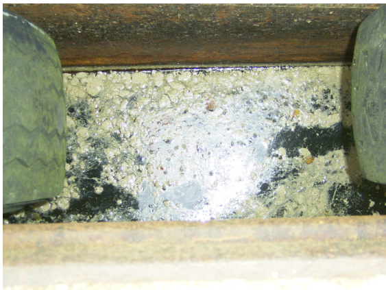
Bilde 1: Dette bildet er tatt mellom dekkene som hindrer den langtidslagrede prammen å slå mot kaikanten.
