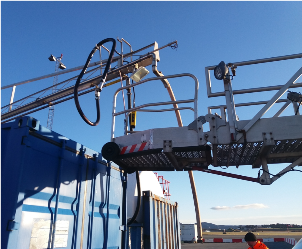
Glykolslangene henger enten ned eller på en krok. Den lyse slanger er for varmt vann
