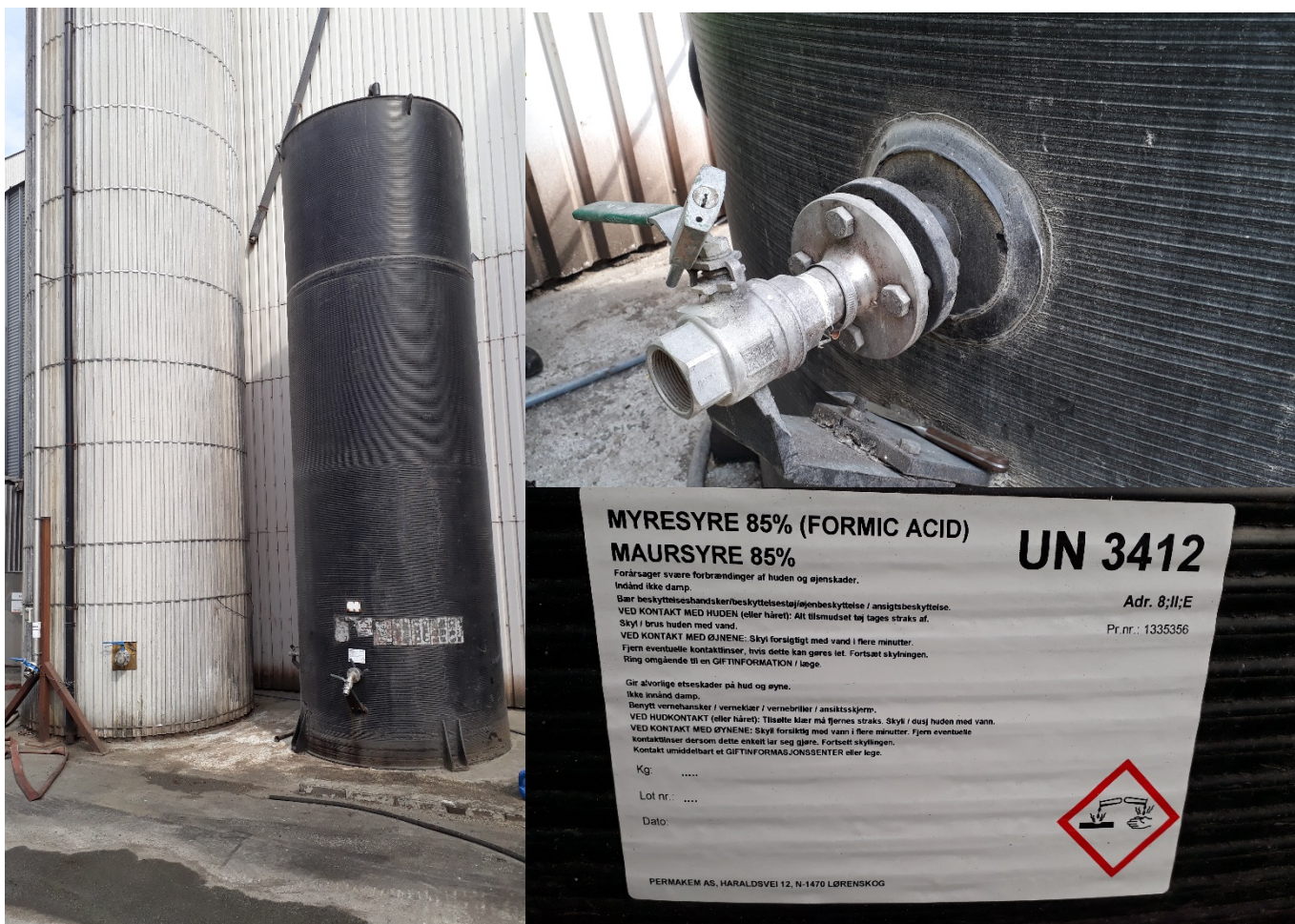
Bilde 1, 2 og 3: Svart 40 m 3 maursyretank (85%) uten oppsamlingsarrangement. Et uttak var sikret med hengelås.
