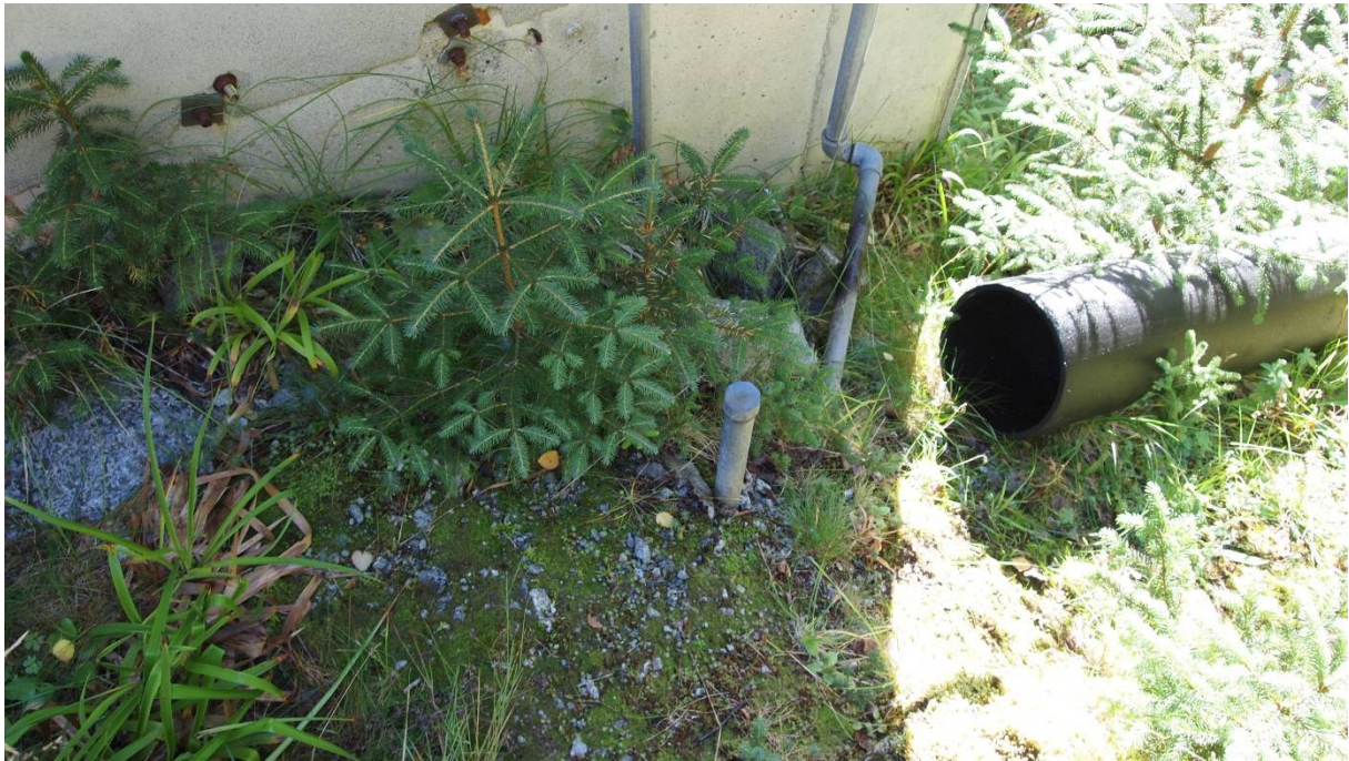
Bilde 2. Nedgravd dieseltank.
