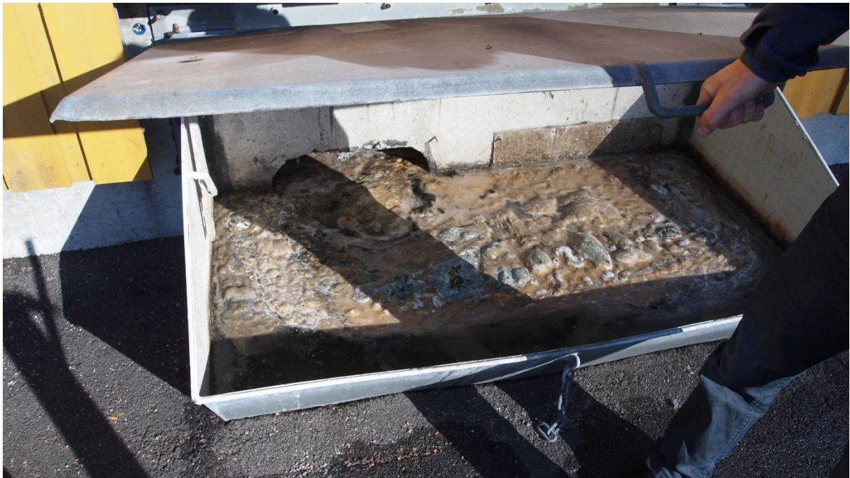
Bilde 3. Slamtank ved renseanlegg.
