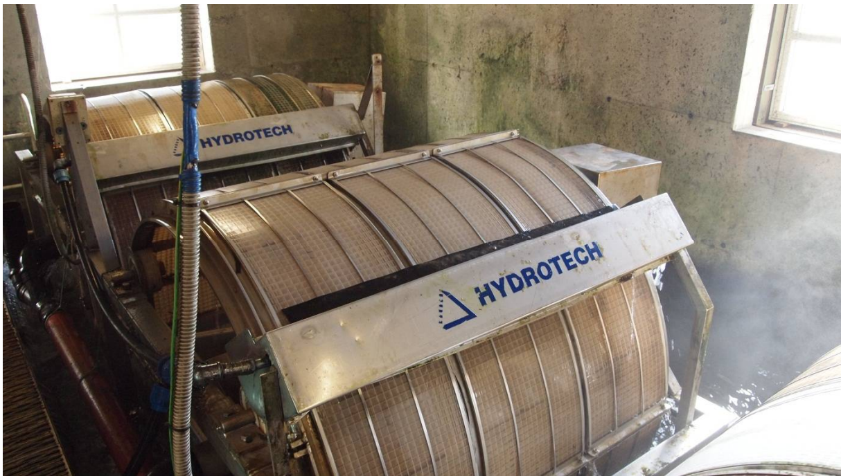
Bilde 5. Renseanlegg med Hydrotechfilter.
