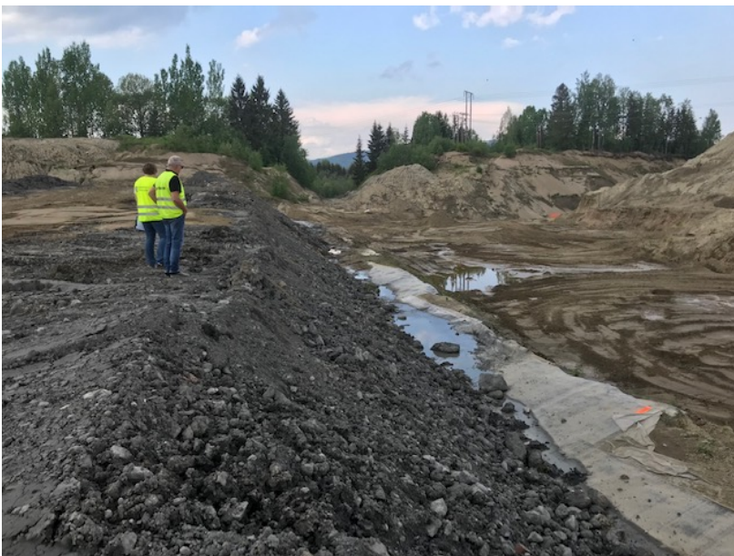
Figur 1 Sidekant deponi. Sigevann renner over bunn-/sidetetting (se avvik 2)
