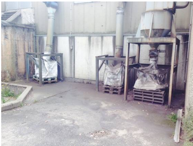
Bilde 2. Ødelagt pose for oppsamling av støv fra renseanlegget ved utkast (den midterste posen). I forkant av bildet ses avløp med utslipp videre til sjø.
