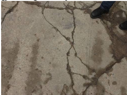
Sprekker i betongen
