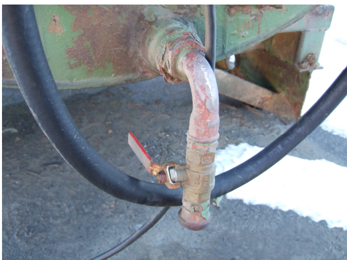
Bilde 2: Usikret kran på dieseltank bør sikres for å unngå forurensning ved uhell.
