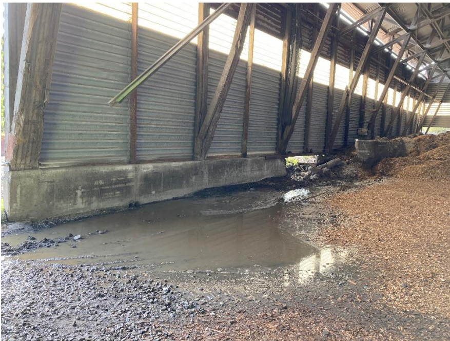
Figur 7, forurenset vann fra innendørs håndtering og lagring av avløpsvann og kompost føres på sigevannsledningen.
