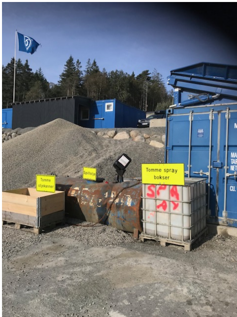
Bilde 1: Tank for lagring av spillolje, midt i bildet
