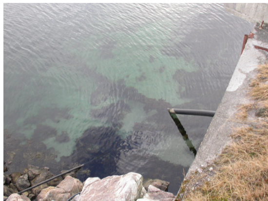
Bilde 4: Utløpsledning sedimenteringsbasseng
