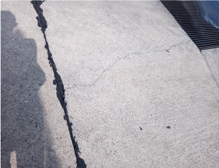
Bilde 1 Utilstrekkelig tetting på brannøvingsfeltet
