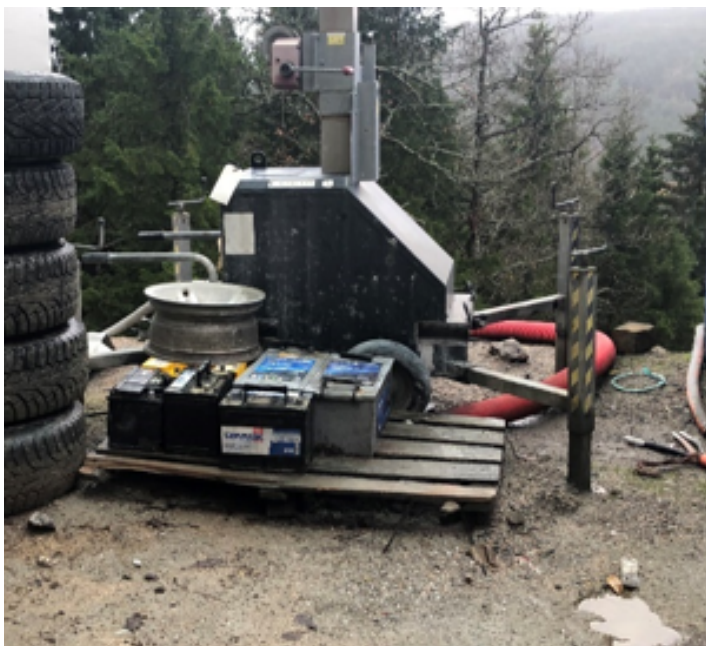
Bilde 1 – Viser utendørs lagring av batterier observert ved tilsynet.
