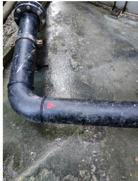
Bilde 1: Deler av tidligere merking på rørgate.
