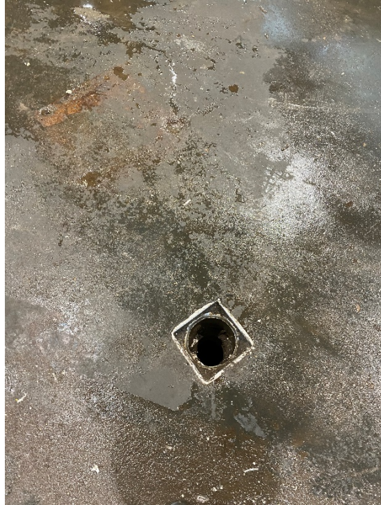
Bilde 6: Hull i gulv inne i lagerbygget
