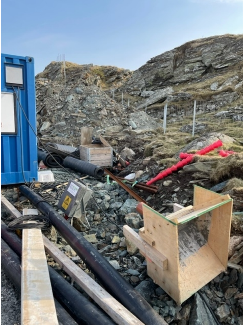
Bilde: Uryddig område ved anleggsområde for peling av bru, K51
