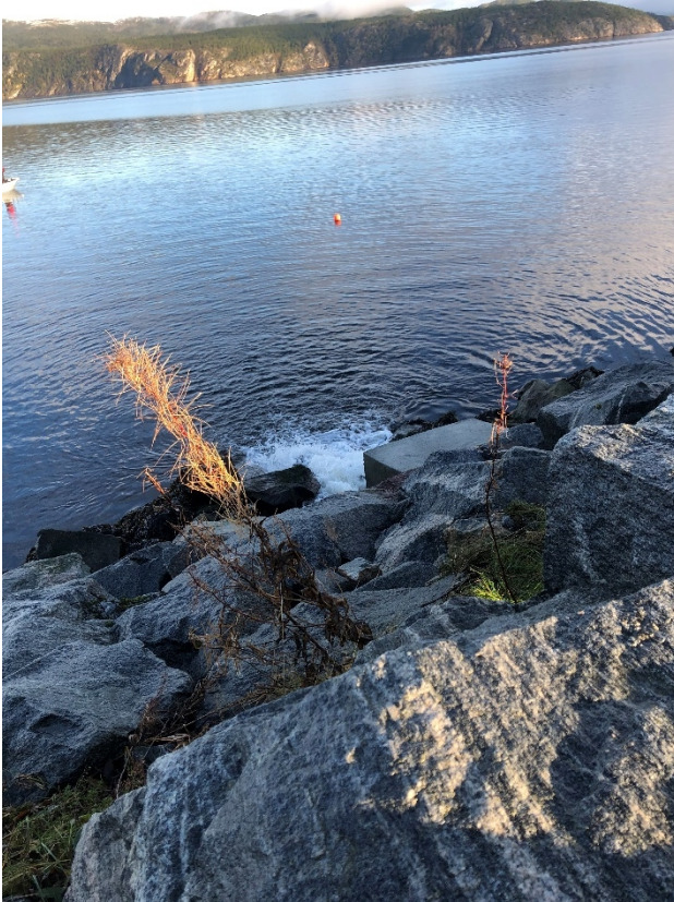
Figur 1. Avløp som går til overflaten.
