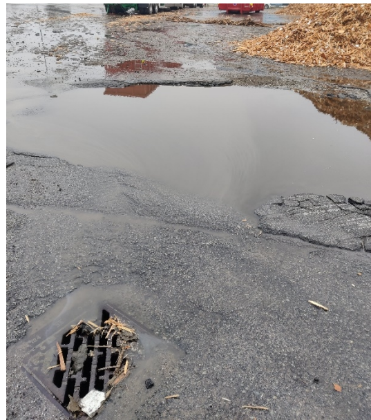
Bilde 4: Hull i dekket ved overvannskum på fremsiden av lagringsområdet
