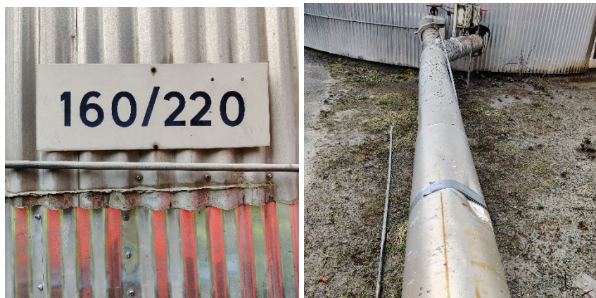
Bilde 3 og 4. Utilstrekkelig merking av tank og rør for lagring av bitumen.
