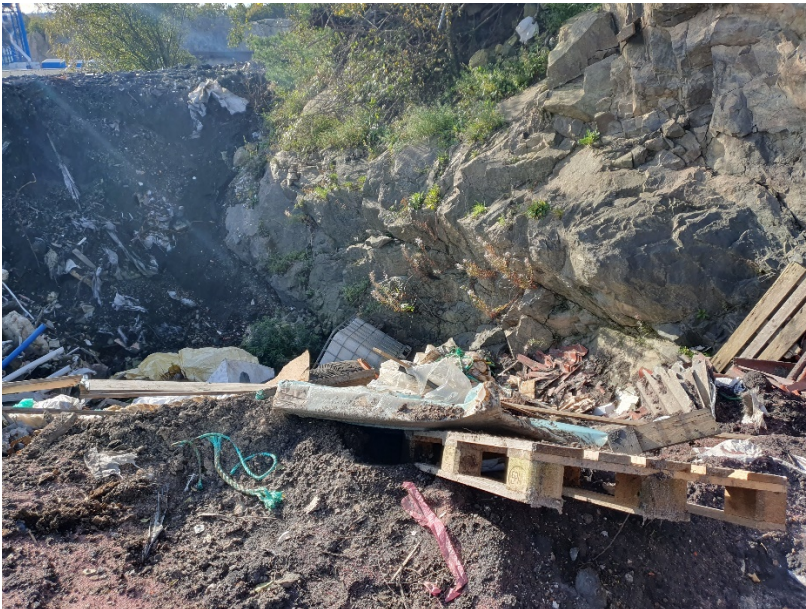
Trepaller deponert sammen med asbestavfall, delvis uten tildekking.
