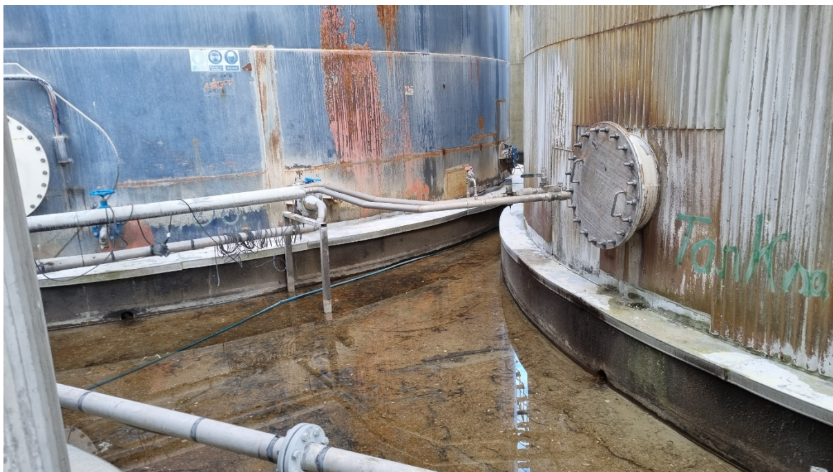
Bilde 2: Oppsamling av vann og slam i oppsamlingsarrangementet.
