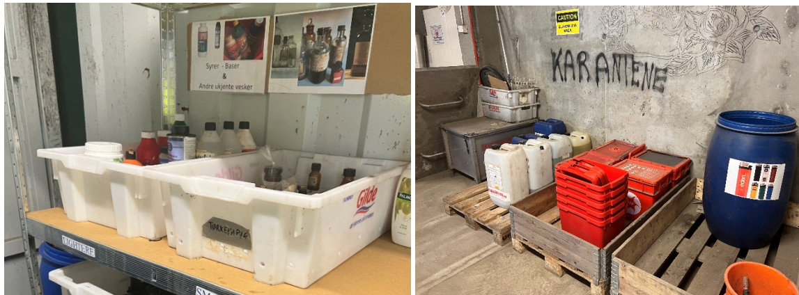
Figur 1: Venstre bilde viser lagring av ukjent farlig avfall i miljøkonteiner uten at dette er merket. Høyre bilde viser farlig avfall i hall 6 som ikke er merket med innhold.
