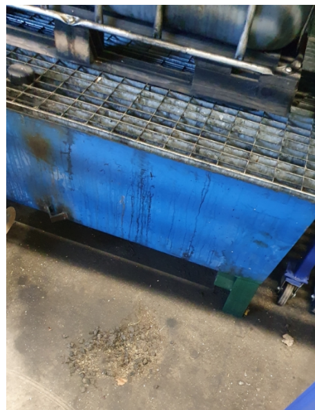
Bilde 1: Hull og sprekker i golv under IBC dunk med farlig avfall på mottakslager. Foto: Statsforvalteren i Agder
