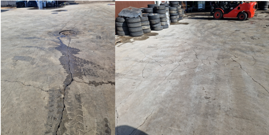
Bilde 1: Hull og sprekker i betongdekke. Foto: Statsforvalteren i Agder.
