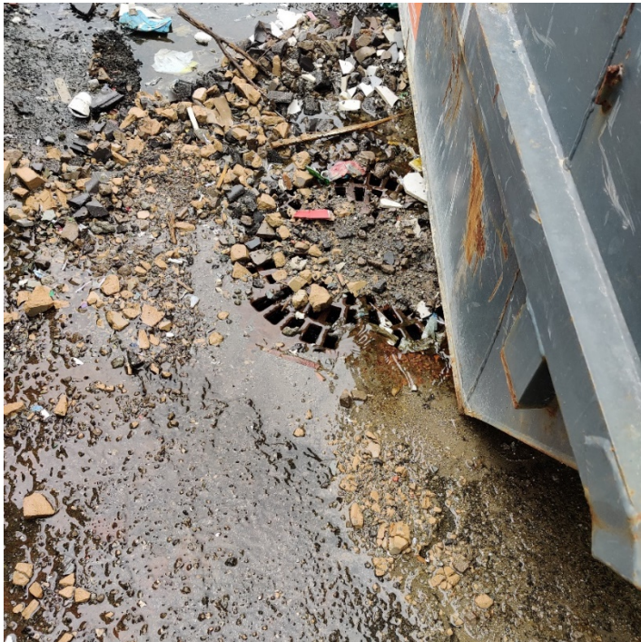
Figur 4 Knust tegl, takstein og fliser i nærheten av overvannskum.
