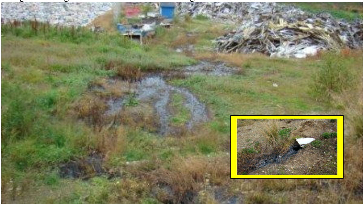
Bildet viser utslipp av urensert sigevann fra sedimentasjonsbassenget for sigevann. Det lille bildet viser selve utslippspunktet gjennom overløpsrør
