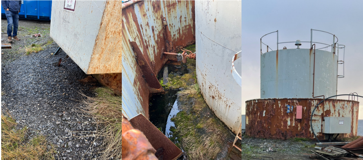
Bilde 1: til venstre: lekkasje tilknyttet tankanlegg, midt: Innsiden av ringmur rundt tank, til høyre: oversiktsbilde av tankanlegg.
