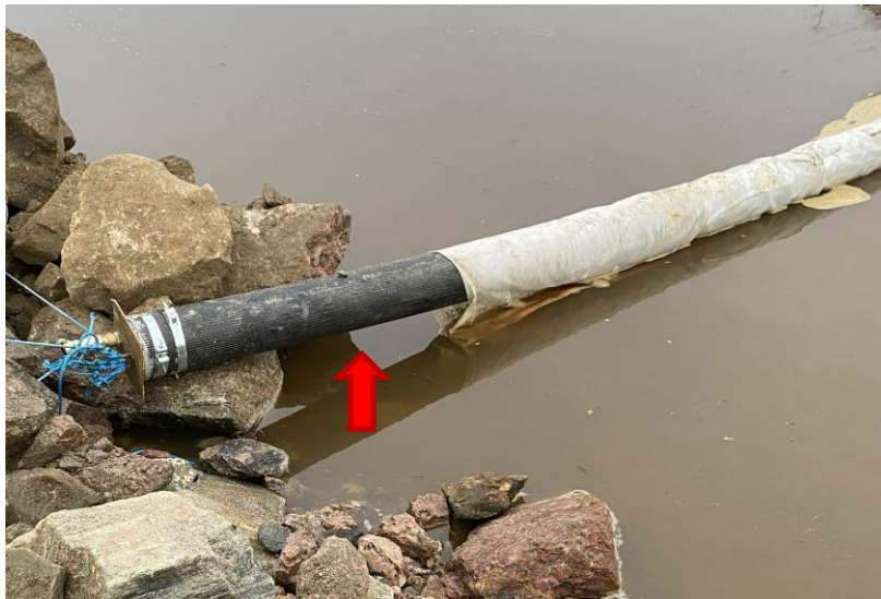
Figur 1: Siltgardinen i Krovann, fotografert under befaring den 13.11.2025. Rød pil viser hvor vannet passerte forbi gardinen. Bildet er tatt fra utsiden av gardinen.
