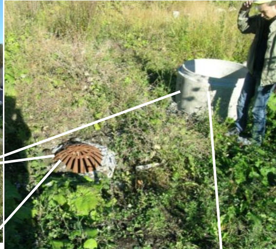
Bilde 14 Kummer for sigevanns- og overflatevann nedenfor fyllingsfot
