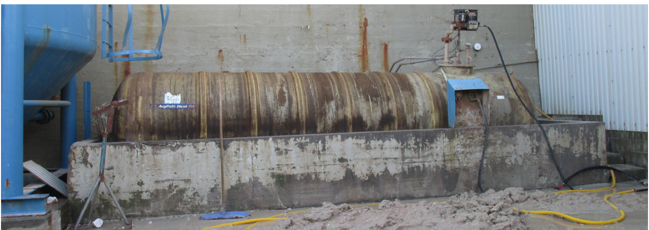
Bilde 2: Utfaset dieseltank
